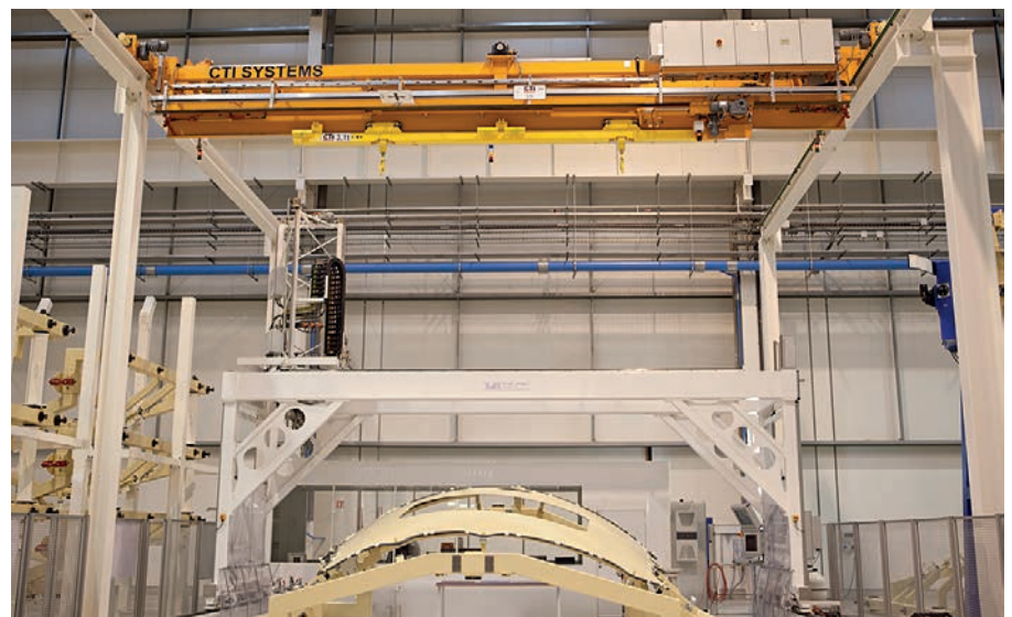
Bild 1. Kranbahnträger mit Brückenkrane (© CTI Systems S.A.)
