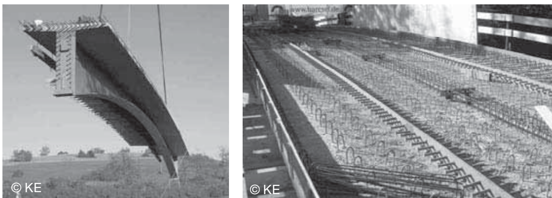
Figure 2.46 : Montage d'une poutre mixte préfabriquée à goujons horizontaux près de Münsigen, Allemagne
